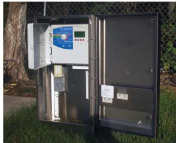
Pedestal de sistema de control en paquete
